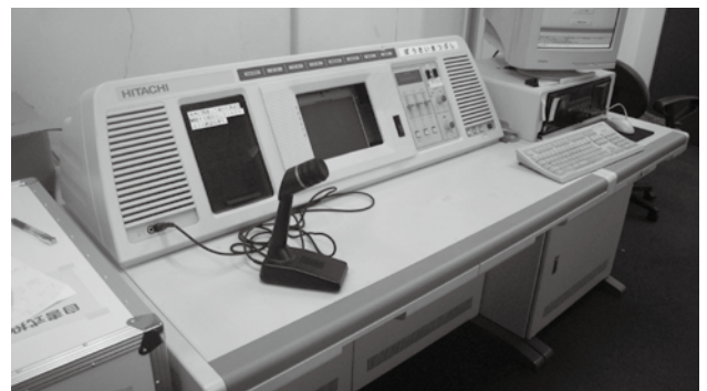
老朽化した防災行政無線
